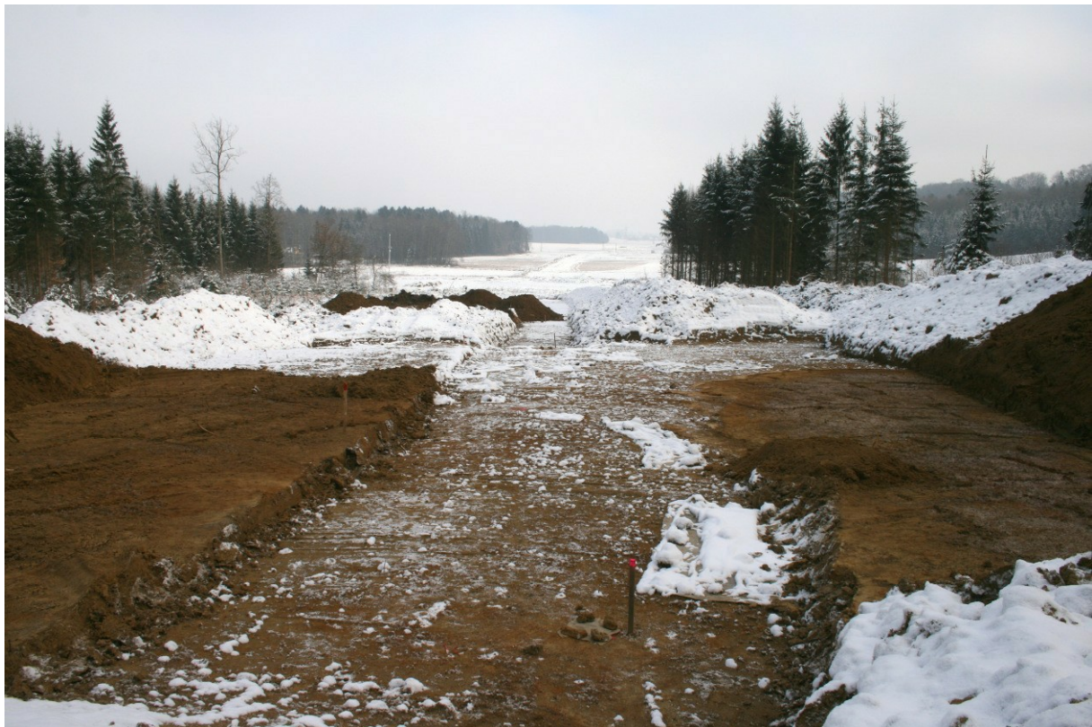
Abb. 76: Freidorf an der Laßnitz, Bereich Koralmtunnel-Ostportal (offene Bauweise), maschinelle Sondierungen in Hanglage, Ansicht gegen Ost, Foto ARGIS, 30.12.2008.
