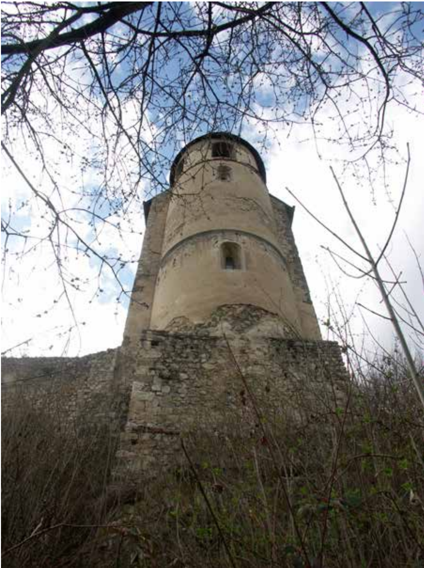
← Abb. 78: Ostfassade Burgkapelle – Apsis, zwei erhaltene originale Doppeltrichter- fenster, Gurtgesims und jüngeres Glockengeschoss mit Schallfenstern ohne Hausteine
