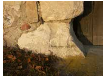
Abb. 34: Ruine Gösting, Eingang in die untere Burgkapelle, linker Laibungsstein des Portals; der Prellanlauf ist nachträglich entstanden
