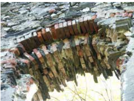
← Abb. 65: Ruine Alt Wachsenegg, Anger, Steiermark, Rest einer Fensterverdachung mit gleichem Ausbruchbefund wie bei den Fensteröffnungen des großen Palas von Gösting
